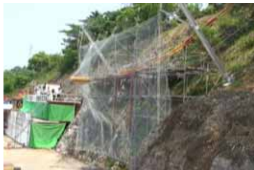
図 - 8 1.0t の重錘を衝突させたときのネットの変形 2)
